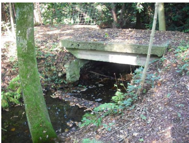
foto: lozingspunt huishoudelijk afvalwater in bestand 10a
